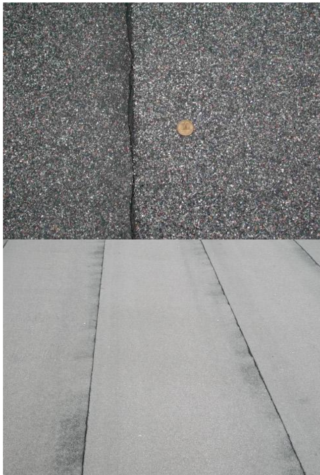
36 pav. Pro siūlę pratekėjusi polimerinė - bituminė masė (palyginimui - 10 centų moneta.)
